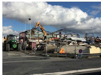
Port de commerce à Brest - Déconstruction d'un restaurant pour accueillir un ensemble immobilier tertiaire (hôtel et bureaux) - Crédit : Adeupa
